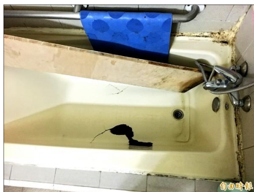
陽明老人公寓設施老舊 圖四
