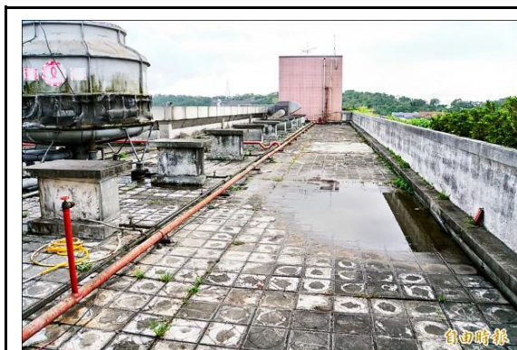
陽明老人公寓漏水屋頂 圖三
